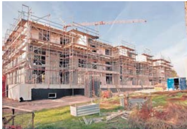
Die Maurer- und Betonarbeiten am dreigeschossigen Neubaus sollen in drei Wochen abgeschlossen sein.
